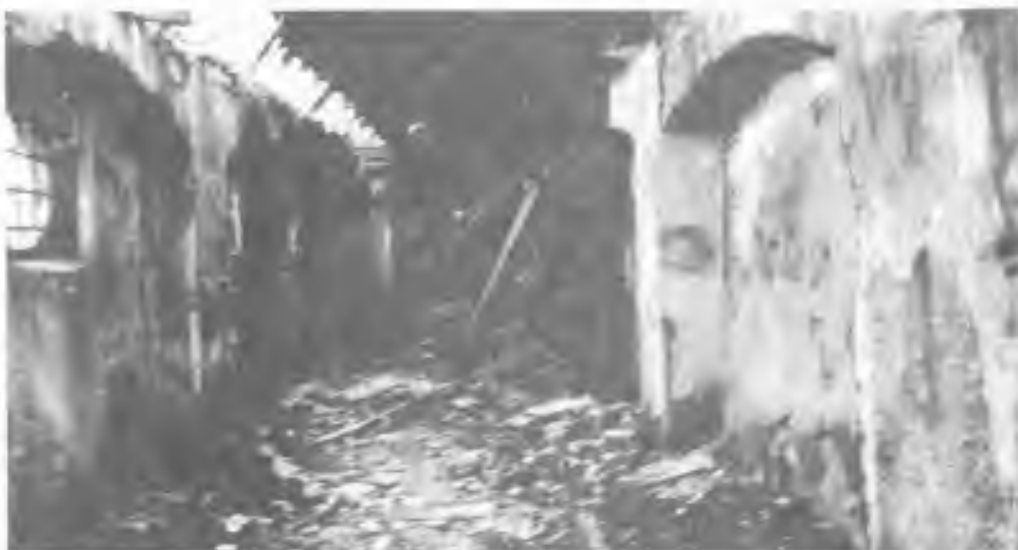
Hoe bouwvallig de aanloop naar de trap er uit ziet maakt deze foto schrijnend duidelijk. Er dreigt instortingsgevaar.
