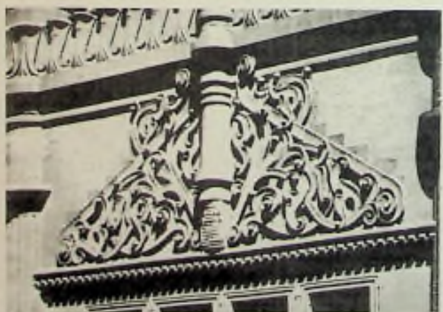
Fotografický záběr Terra cotta ornamentu na budově Rookery na La Salle Str. Ornament, ve
