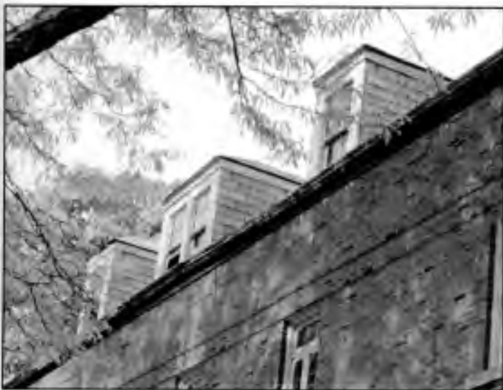
Podkrovi s pohostinskými pokoji před opravou. Zatékající střecha byla opravena, střešní vykře propojeny dvěma trojdílnými okny, nad nimiž se zvedl strop. V pohledu na fasádu domu vidíme ještě původní okna.
